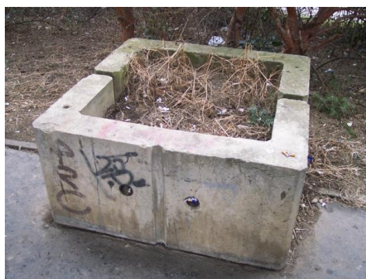
Obr. č. 20: Betonový prvek
