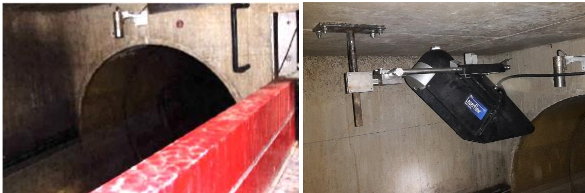
Obr. 4.28 Měrný profil Q3 a průtokoměr LaserFlow
