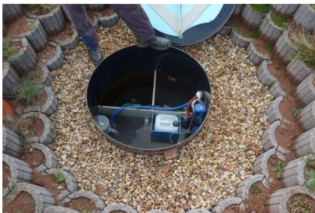
Obrázek č. 2 – Fotografie čistírny odpadních vod s funkcí SBR
