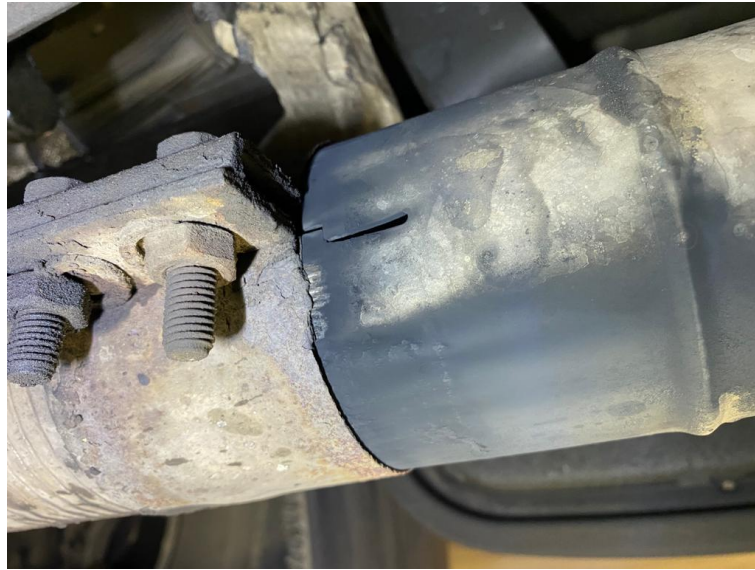
Obrázek 41 - Netěsnost výfukového potrubí [9]
