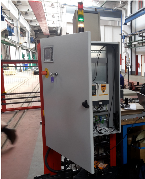
Obrázek 3.5: Rozvodná skříň vně klece
