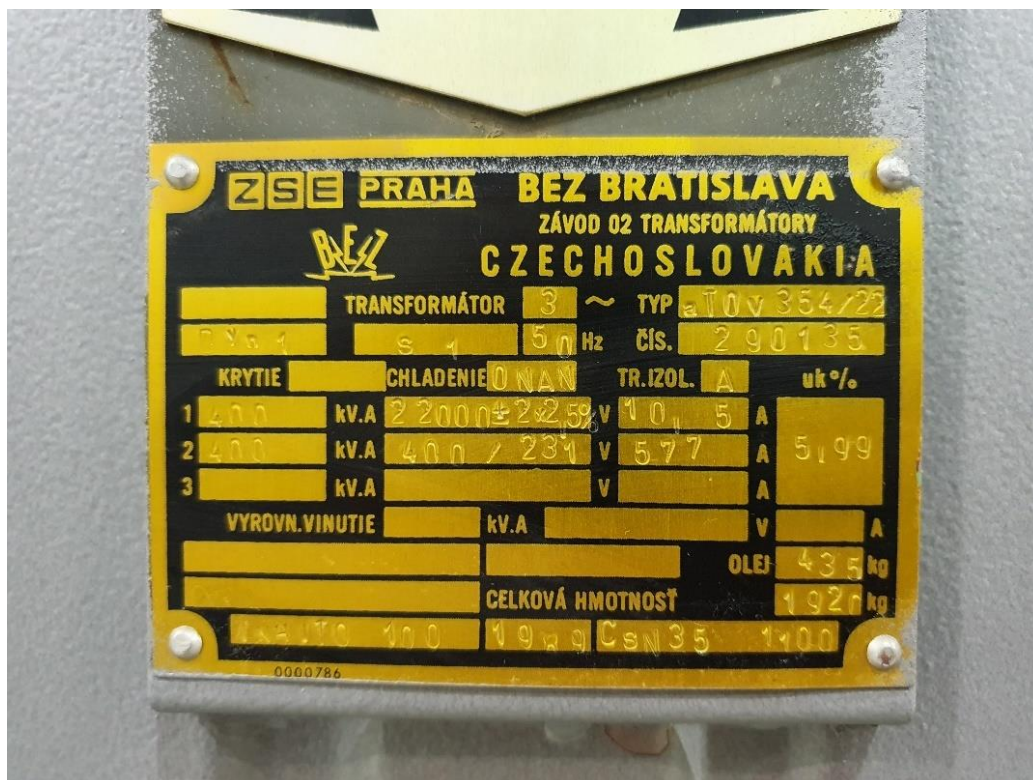
Obr. 3-2 Štítok skúšaného transformátora
