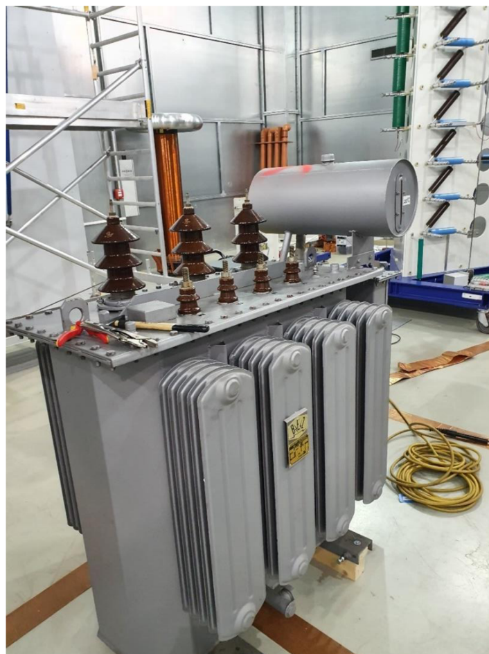
Obr. 3-1 Skúšaný distribučný transformátor
