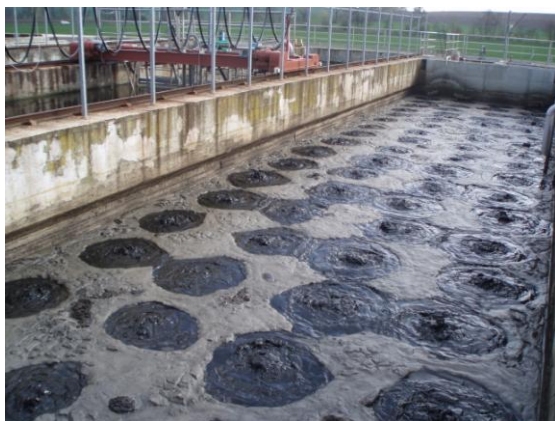
Obr. 3 – Čistička odpadních vod
