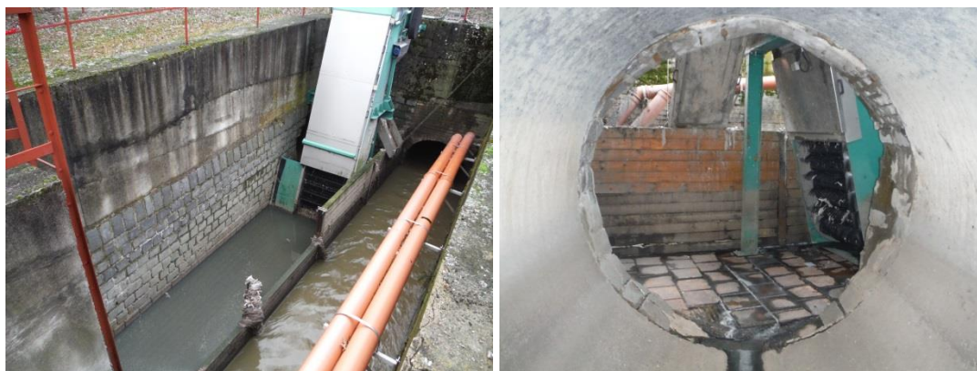
Obrázek 1 a 2: Odlehčovací komora OK ČOV Drahovice vybavena automatizovanými česlemi k zachycení pevných splavenin.
