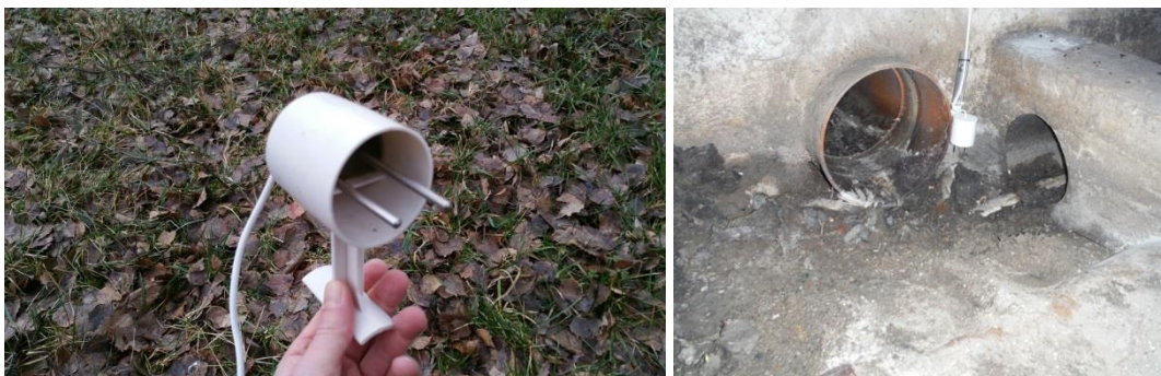
Obrázek 27 a 28: Čidlo indukující zaplavení při proklemování el. kontaktů – obrázek vlevo; umístění čidla indukujícího zaplavení na DIN lištu v OK č. 23, Dalovice, Hlavní ul. x Všeborovická ul., u masny – obrázek vpravo.
