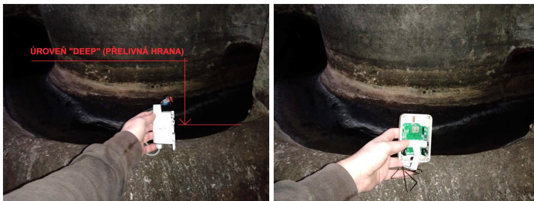
Obrázek 17 a 18: Měření / odeslání informace do Dataskladu z úrovně DEEP, z přelivné hrany OK, vlevo zařízení LoRa, vpravo zařízení SigFox.
