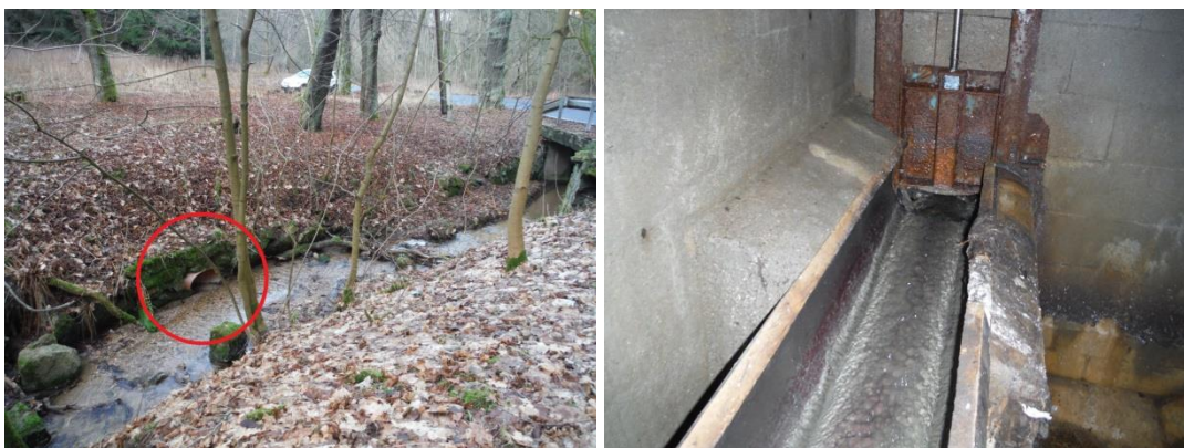
Obrázek 3 a 4: Výúst OK Háje, u mostu, PVC trouba profilu DN 400 s vyústěním do Cínového potoka v konkávním břehu; OK Háje, u mostu, s přepadem oboustranným bočním zavěšeným s přímými hranami, doplněno stavítkem na odtoku.
