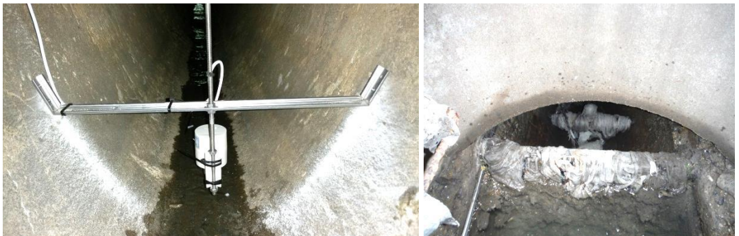
Obrázek 36 a 37: Záplavové čidlo na speciální konstrukci v revizní šachtě na odlehčovací stoe - obrázek vlevo; záplavové čidlo, kryté v kombinaci s česlemi po přivalovém dešti - obrázek vpravo.
