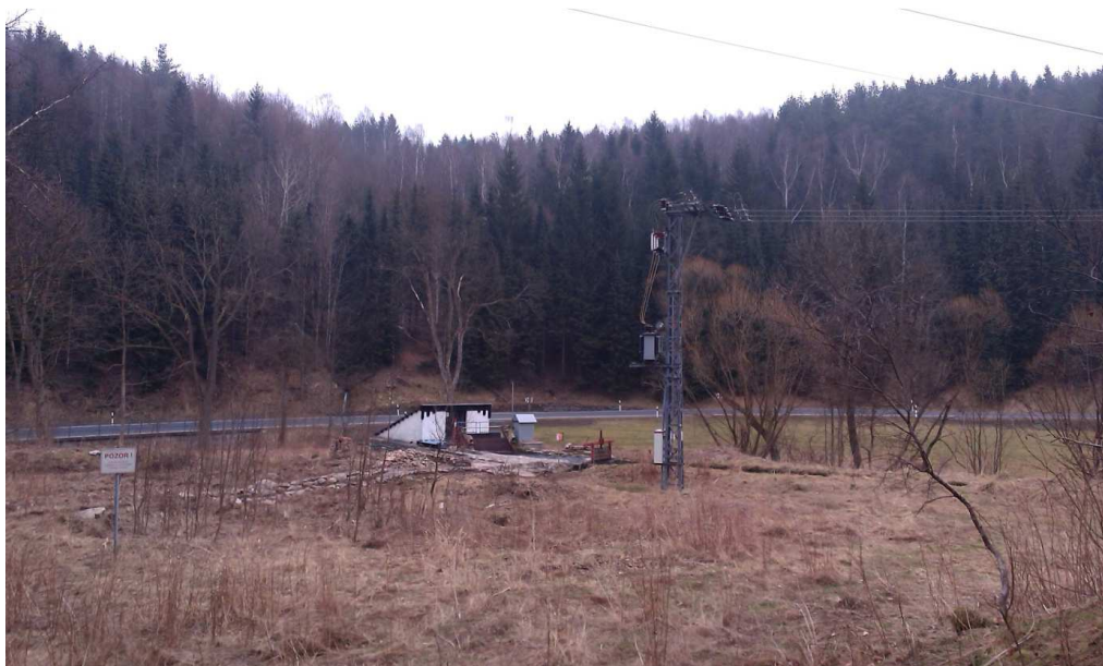
Obr. č. 10 Sloup elektrického vedení při malé vodní elektrárně v Hoře Svaté Kateřiny
