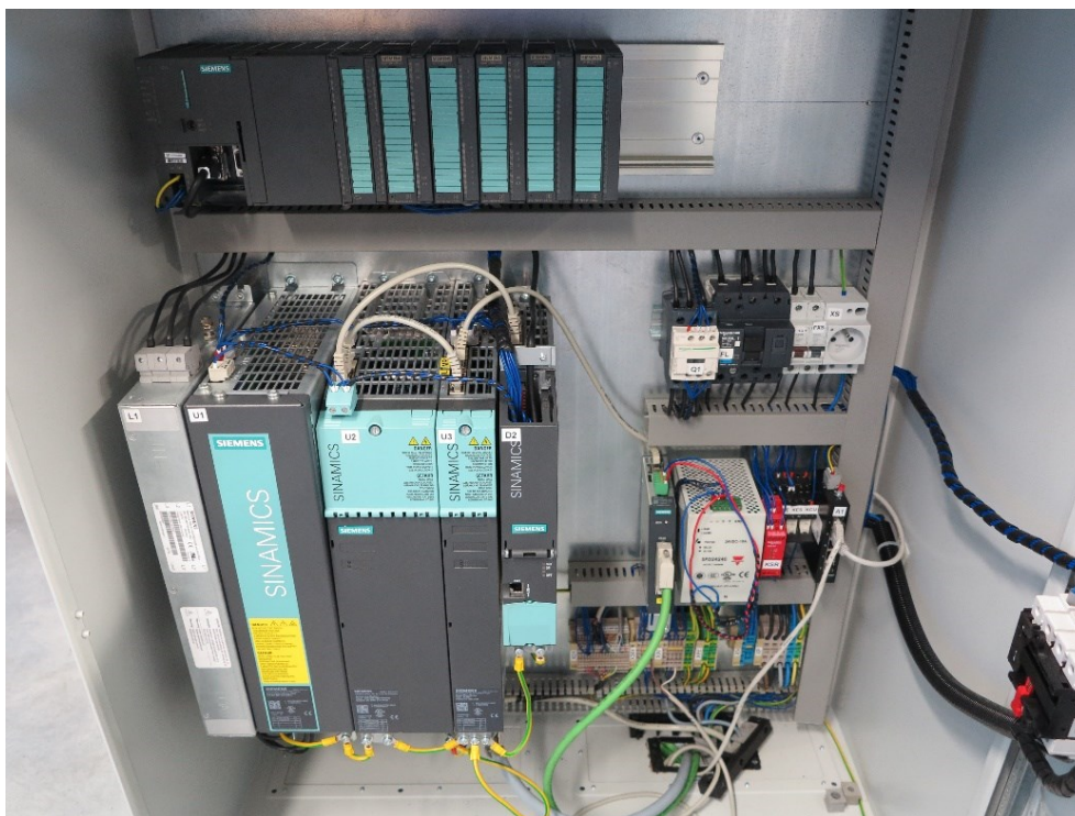
Obr. 13-2 – Rozvaděč s jednotlivými elektrickými prvky a komponentami pro řízení motoru Siemens
