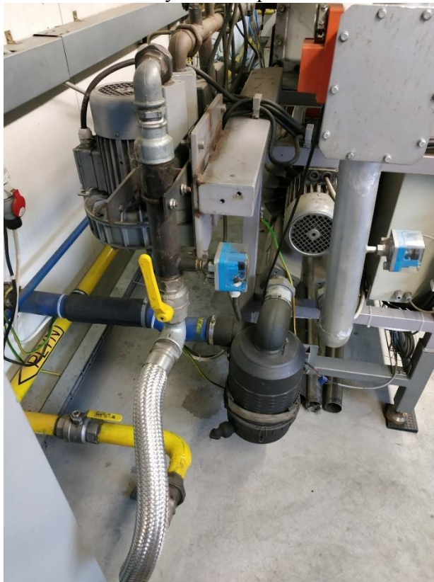
Obr. 6.7 Místo pro měření průtoku zemního plynu
