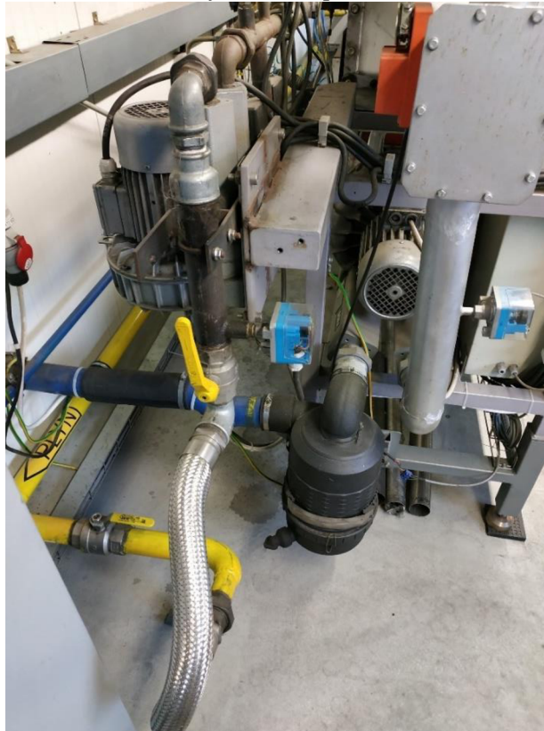
Obr. 6.7 Místo pro měření průtoku zemního plynu
