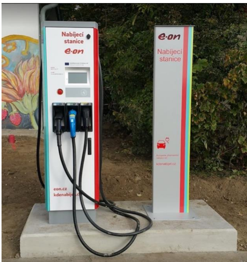
obr. 2-7 Dobíjecí stanice společnosti E.On [11]
