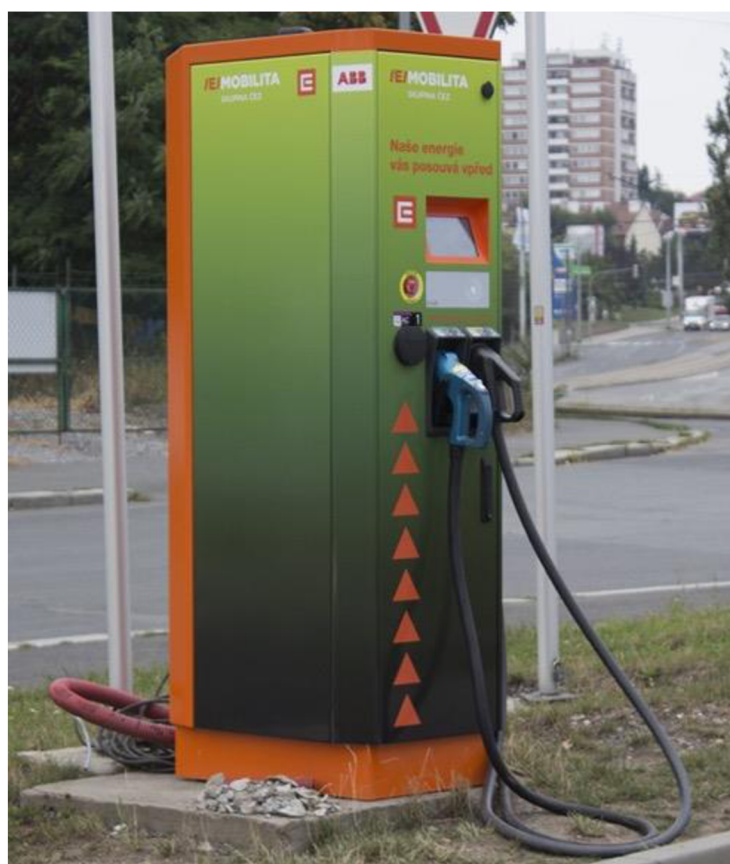
obr. 2-6 Běžná dobíjecí stanice /E/MOBILITA skupiny ČEZ [10]
