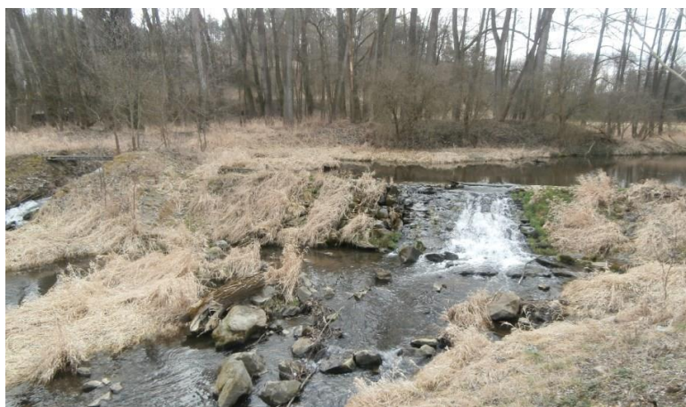
Obr. 50: Špatný technický stav jezu Štěchovice a náletová vegetace v jeho okolí (autor)
