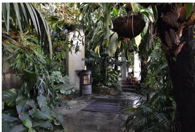
Obrázek 30. Zálohový zdroj tepla - kotel na dřevo
