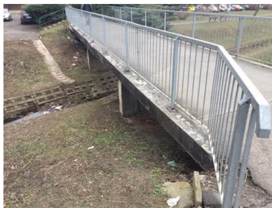
30 Lávka nad Pokratickým potokem v místě, kde je koryto zpevněno opevňovacími tvárnicemi (Foto: Simon, 3/2019)
