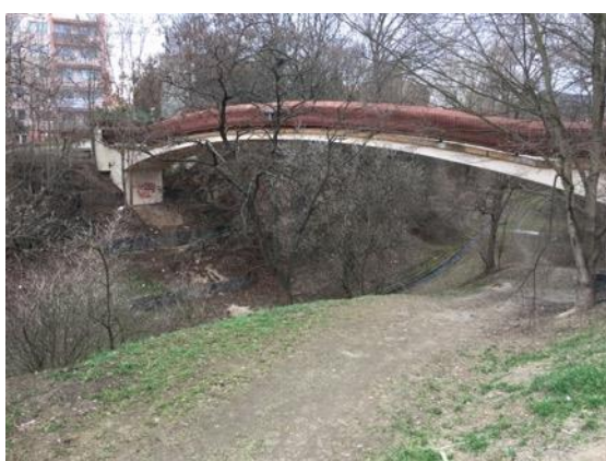
33 Lávka přes Pokratický potok v místě, kde je veden hlubokým údolím (Foto: Simon, 3/2019)
