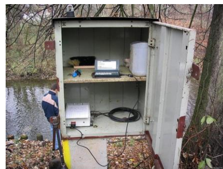
Obr. 29: Vodoměrná stanice ve Velké Bystřici
