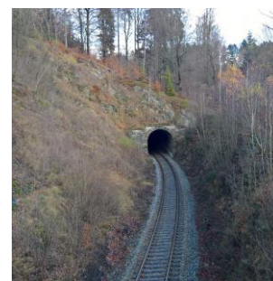
Obr. 140 Domašovský tunel je dlouhý 120 m.
