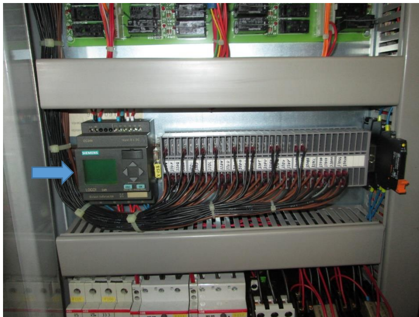
Obrázek 11: Využití programovatelného relé v rozvodné skříní
