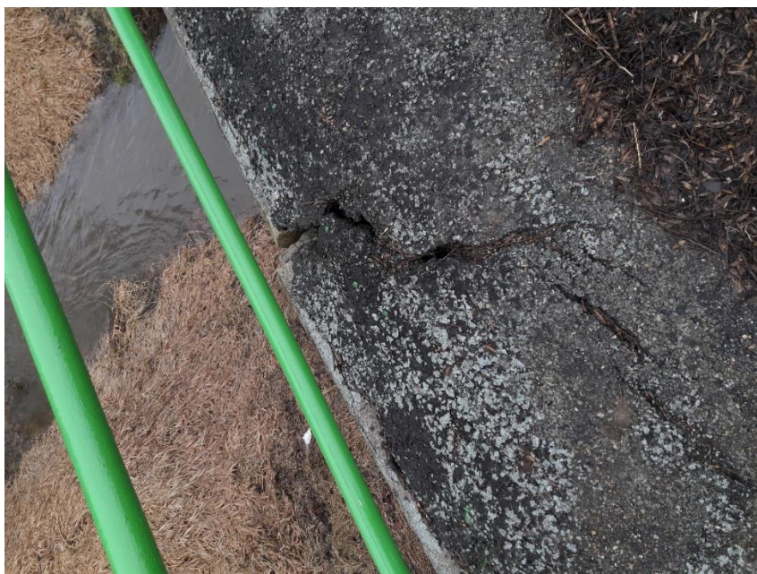
Deformace mostu přetížením (Horní Ves) pohled shora
