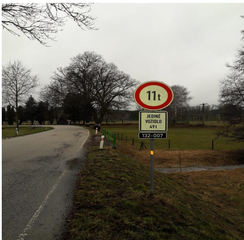
Deformace silnice přetížením (Horní Ves)
