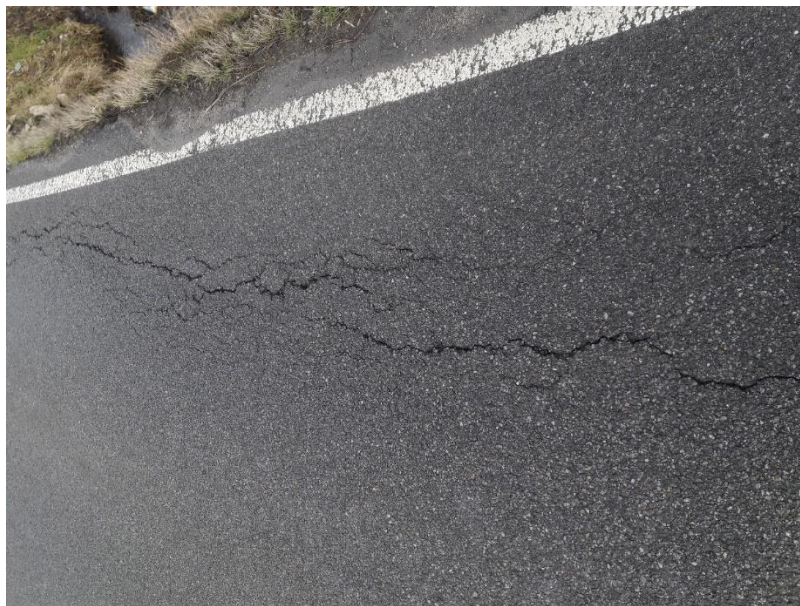
Deformace silnice přetížením (Batelov)
