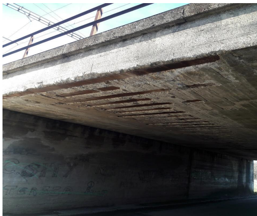
Deformace průjezdu (Horní Cerekev)
