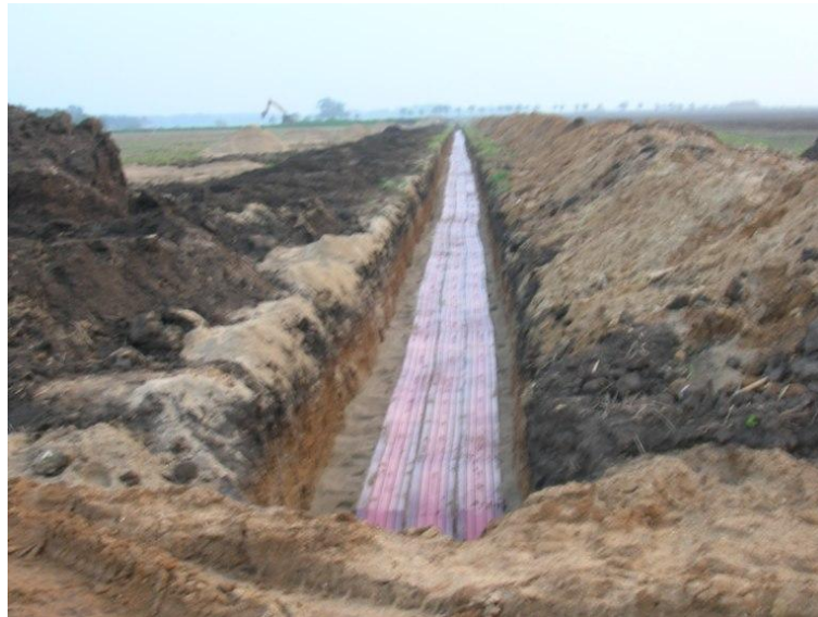
Obr. č. 2: Kabely VN ( http://www.sekv.cz )
