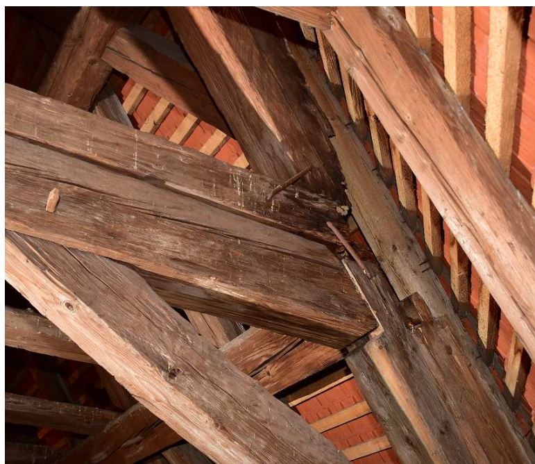
Obr. 25 — Poškození na vazbě PV11 totálně destruovaný spoj na severní straně
