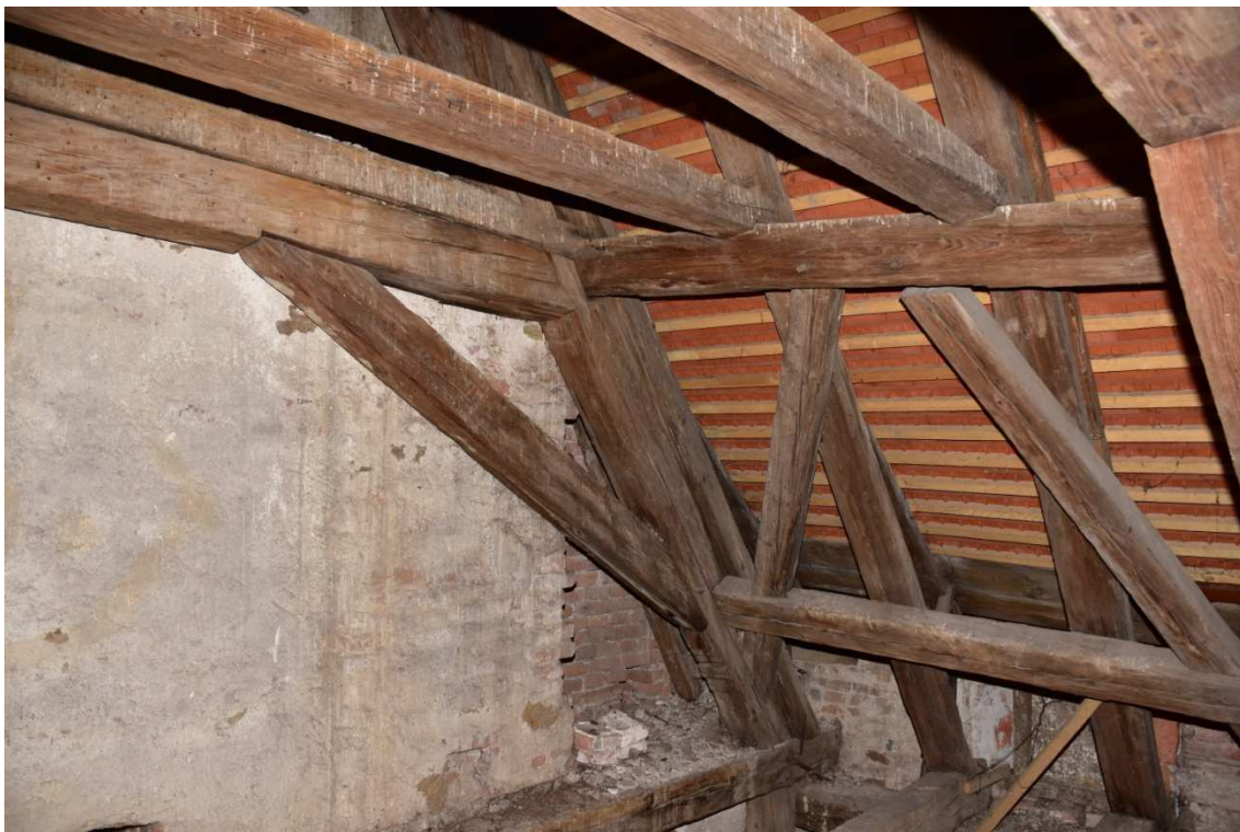
Obr. 21 — Ležatý sloupek PV10 zhlaví sloupku krokve i vazného trámu napadeno hnilobami
