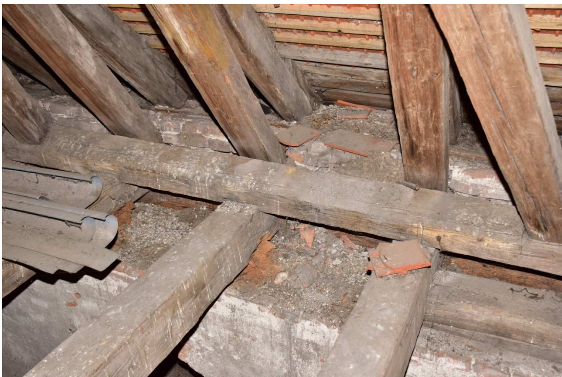
Obr. 18 — destrukce pozednic na severní straně
