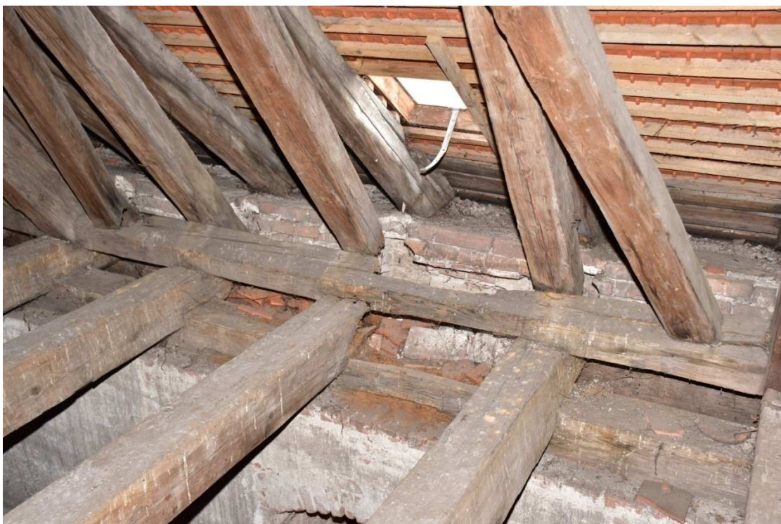
Obr 19 – Destrukce pozednic, zhlaví vazného trámu a pětibokého prahu pod revizním otvorem střechy, (odhalená vnější pozednice)
