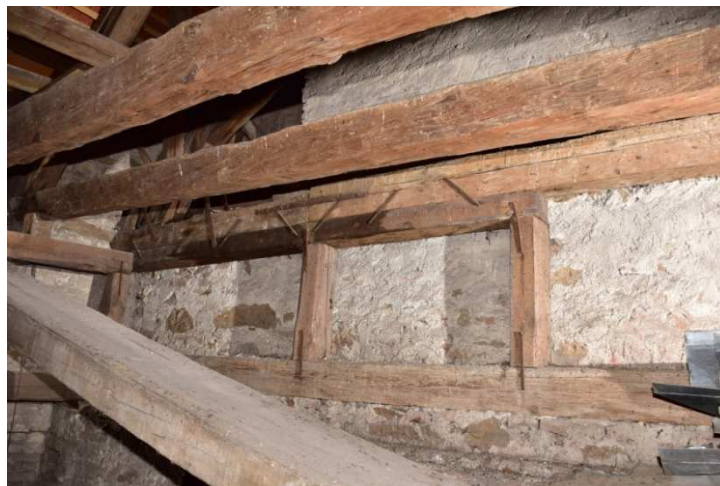
Obr. 13 — Nepůvodní podpěrná konstrukce pod vazbou PV 10
