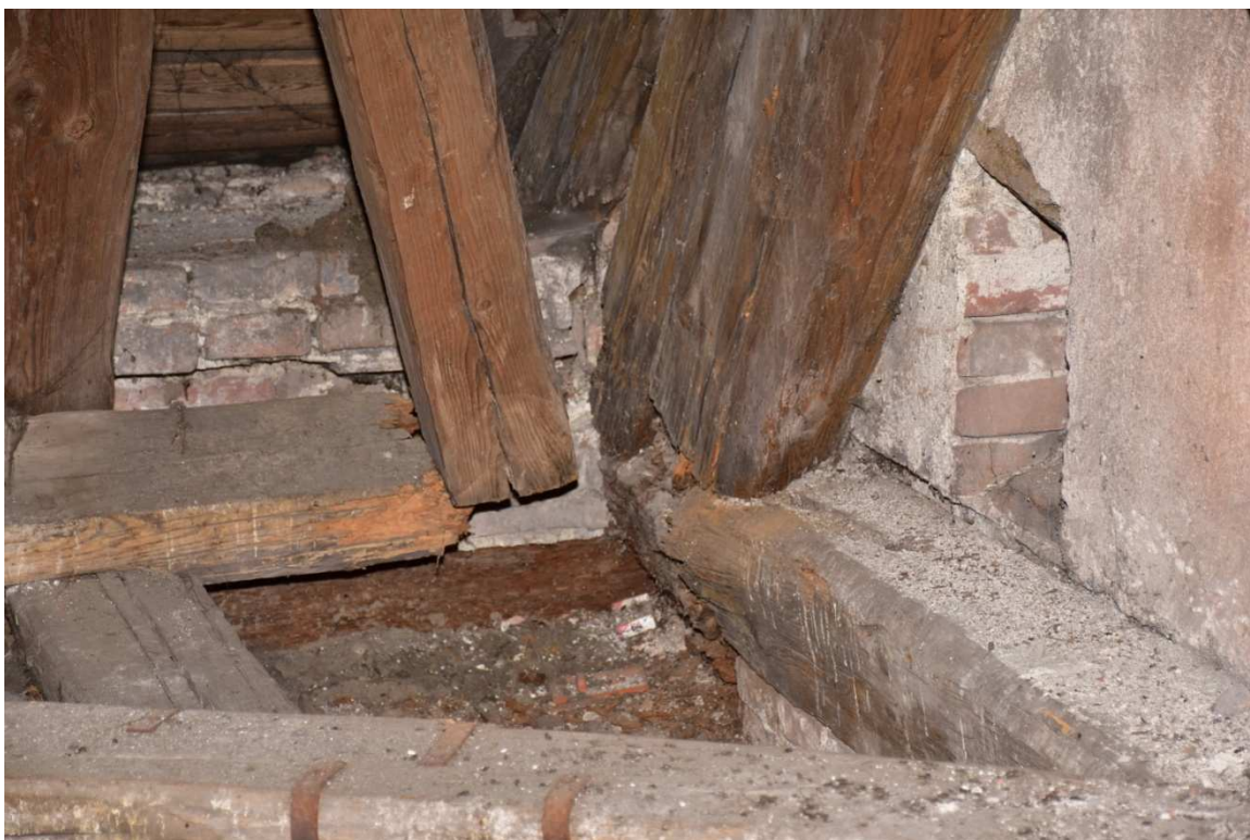
Obr. 17 — Poškození vazby PVI detail spoje vazného trámu s ležatým sloupkem a pětibokým prahem
