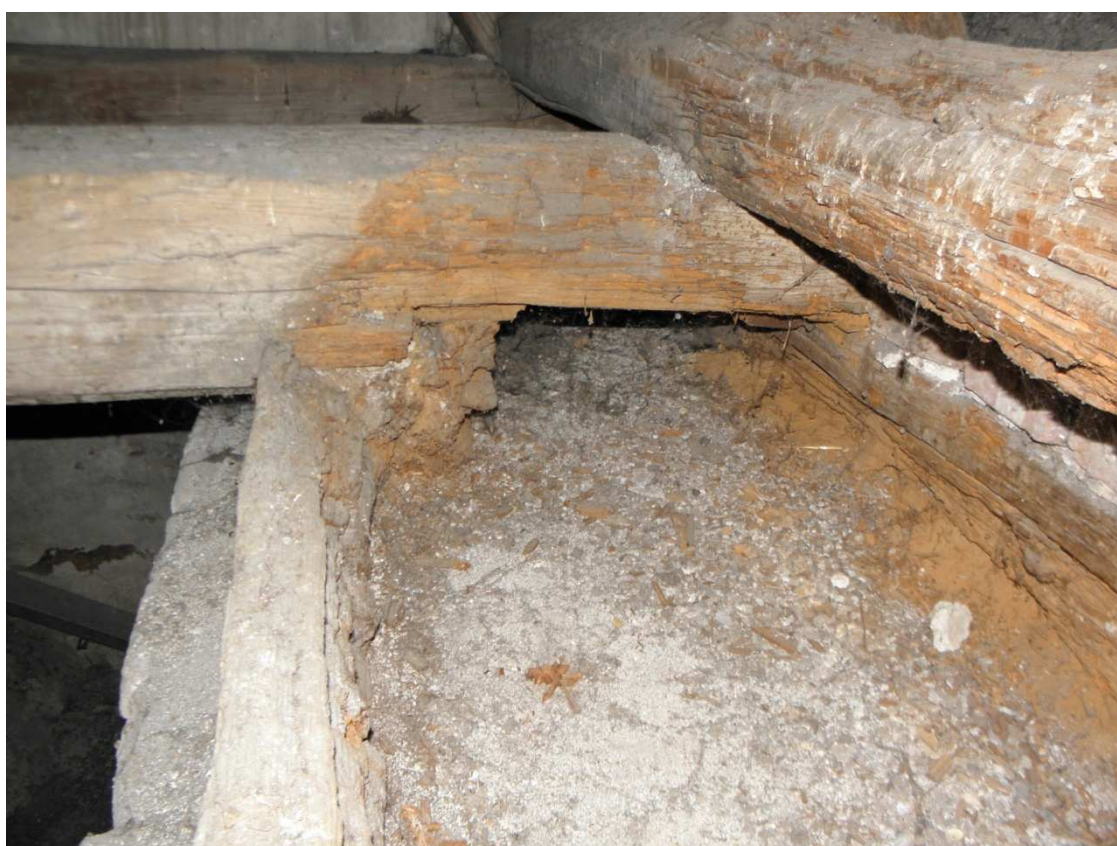
Obr. 27 — Destrukce pozednic a pětibokého prahu
