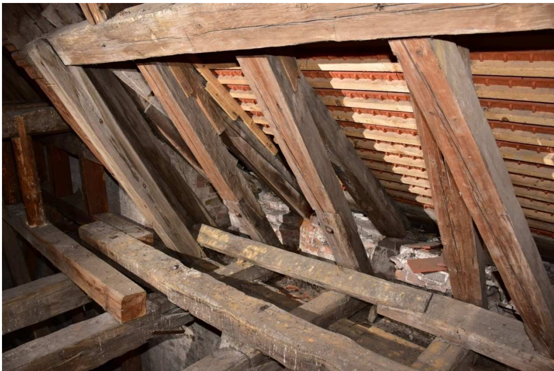
Obr. 20 — Protéza pětibokého prahu, vazných trámů a krokví na severní straně aktivním napadením dřevokazným hmyzem
