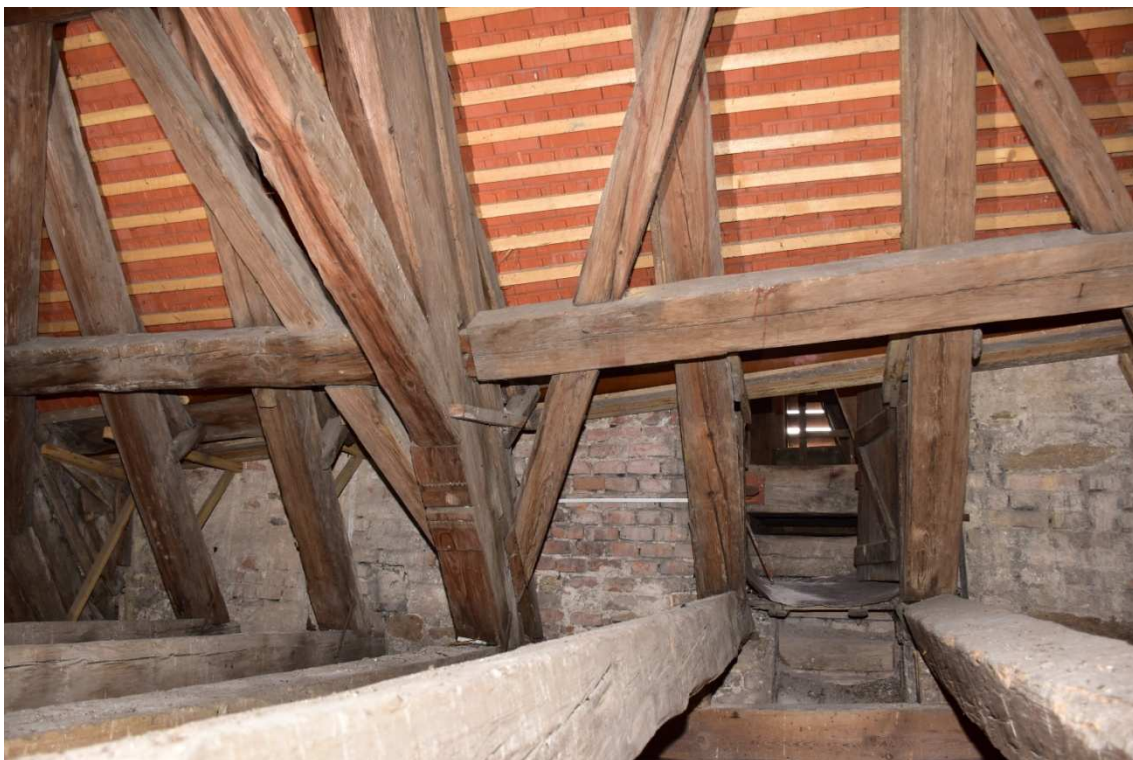
Obr. 22 — Torze vazných trámů a uvolněné spoje u vstupní věže, viditelný pokles vazby PV9
