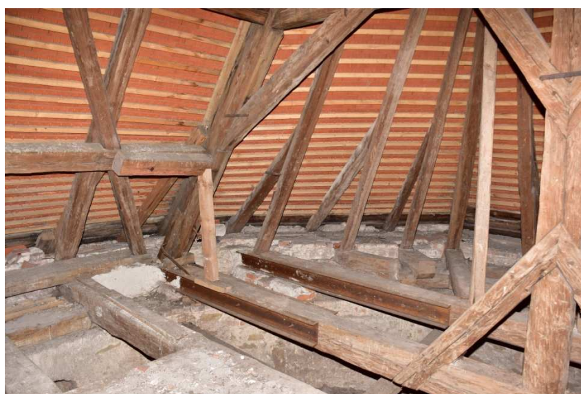
Obr. 16 — Nepůvodní ocelové příložky v krovové konstrukci
