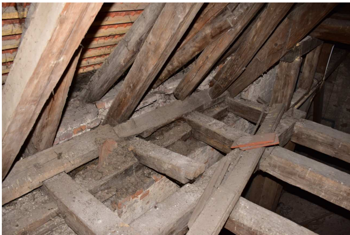
Obr. 23 — poškození konstrukce za vstupní věží (viditelné odhalení vnější pozednice)
