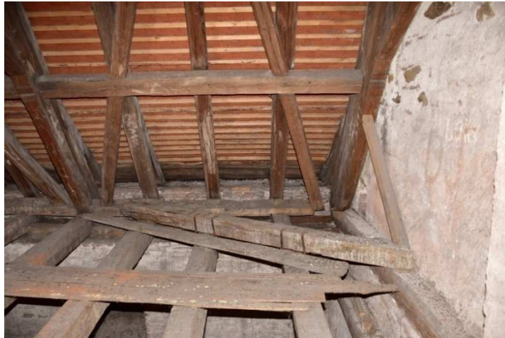
Obr. 12 — Nepůvodní prvky v konstrukci nad lodí u vazby PVI
