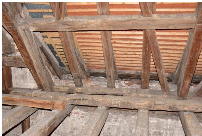
Obr. 14 — Nepůvodní konstrukce vynášející protězy zhlaví vazních trámů a podpěra rozpěry zavětrování
