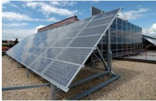
Obrázek 28 Fotovoltaické panely na ploché střeše. (ČVUT) (31)
