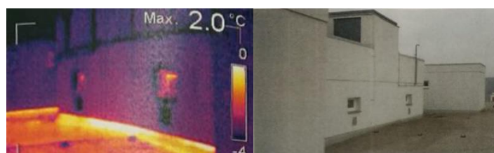
Obrázek 23 Tepelný most na střeše zástavby v místě soklu
