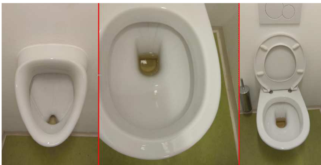
Obrázek 10, Usazeniny po splachování přečištěnými dešťovými vodami v otevření zahradě.
