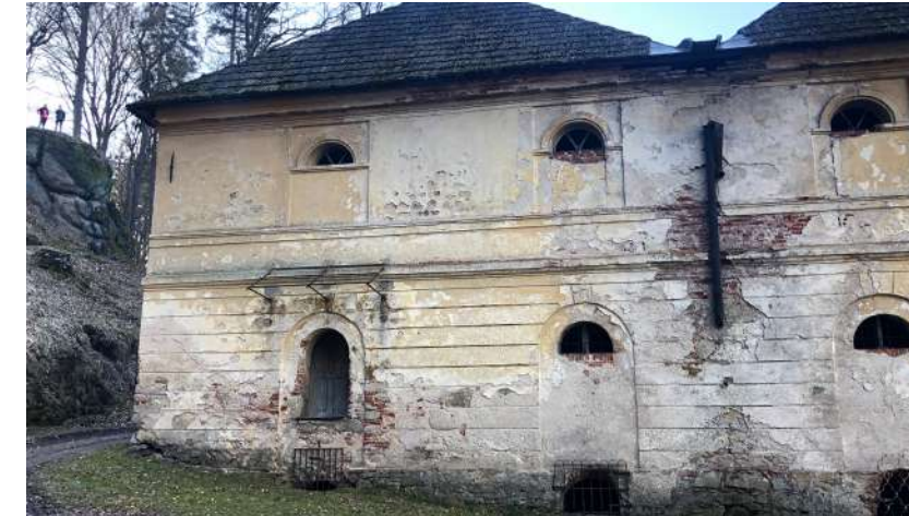
Obrázek 76: Špatný stav budov
