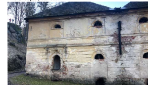
Obrázek 76: Špatný stav budov
