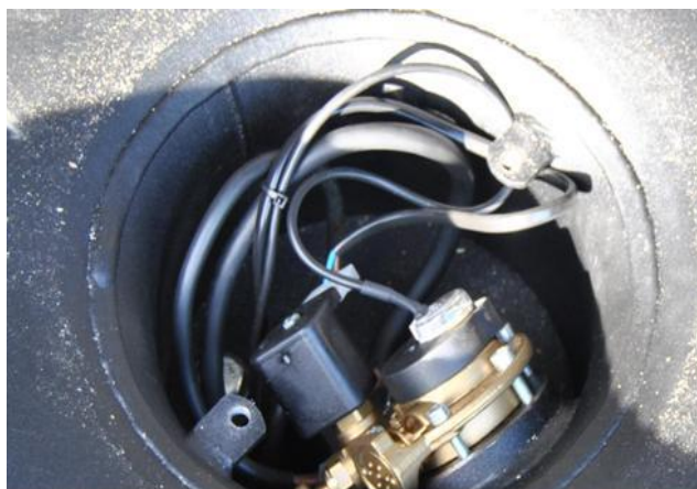
Obrázek č. 5 Multiventil v plynotěsné skříni toroidní nádrže
