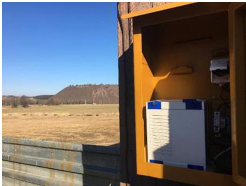
Obr. 28: Osazení monitorovacího zařízení Radim 3AT ve vnějším prostředí (outdoor)
