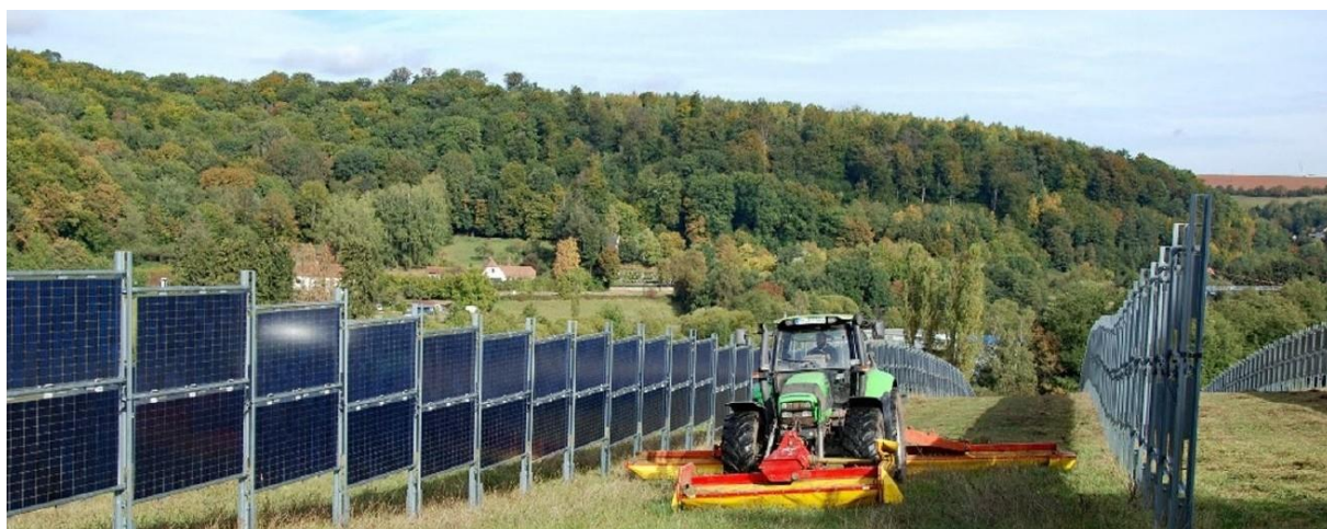
Obr. 12 Svislá instalace FVE panelů
