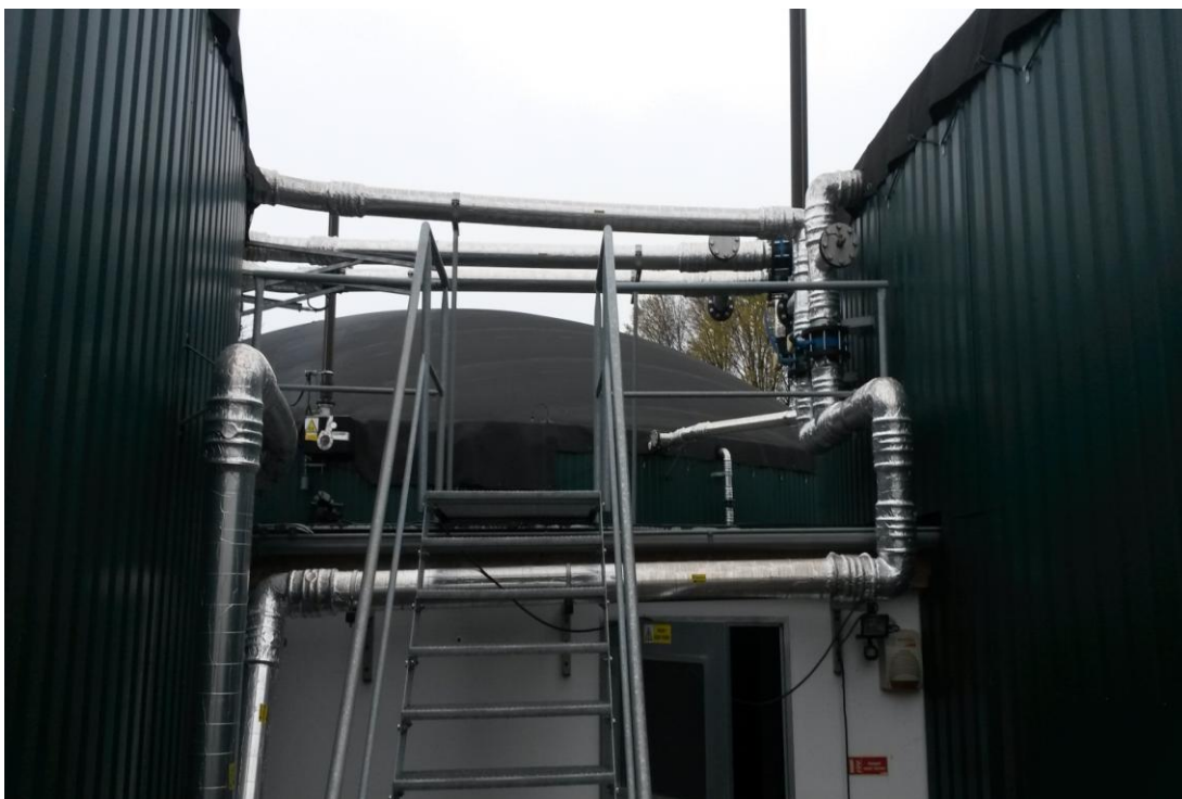
Obrázek 3 – Potrubí odvádějící bioplyn do nádrží, které jsou umístěny v podzemí.
