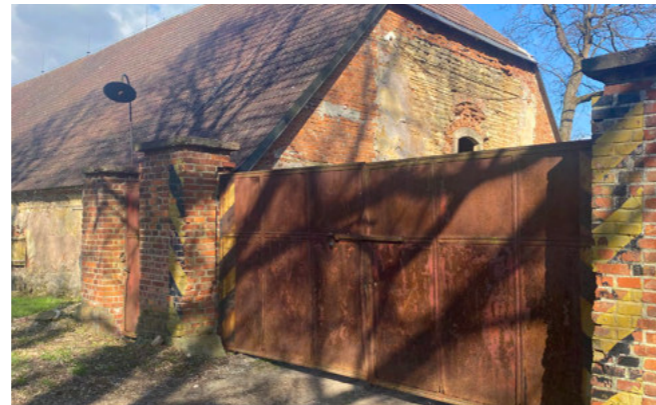
Obr. 4.25: Nevzhledná intervence minulého režimu u historického objektu (Foto autorky)
