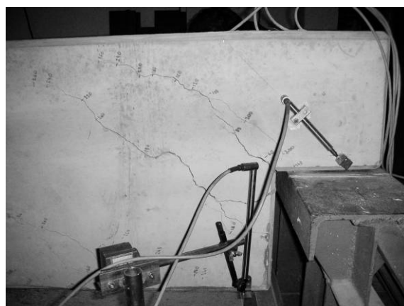
Obr. 6.19 Zhlaví D při dosažení mez. zatížení, max. šířka trhliny 2,00 mm
