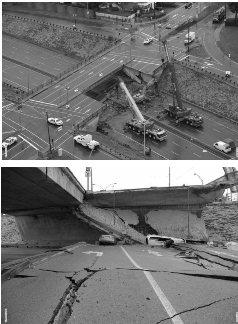
Obr. 2.1 Kolaps silničního nadjezdu v městě Laval (Quebec, Kanada) v roce 2006, převzato z [79]
