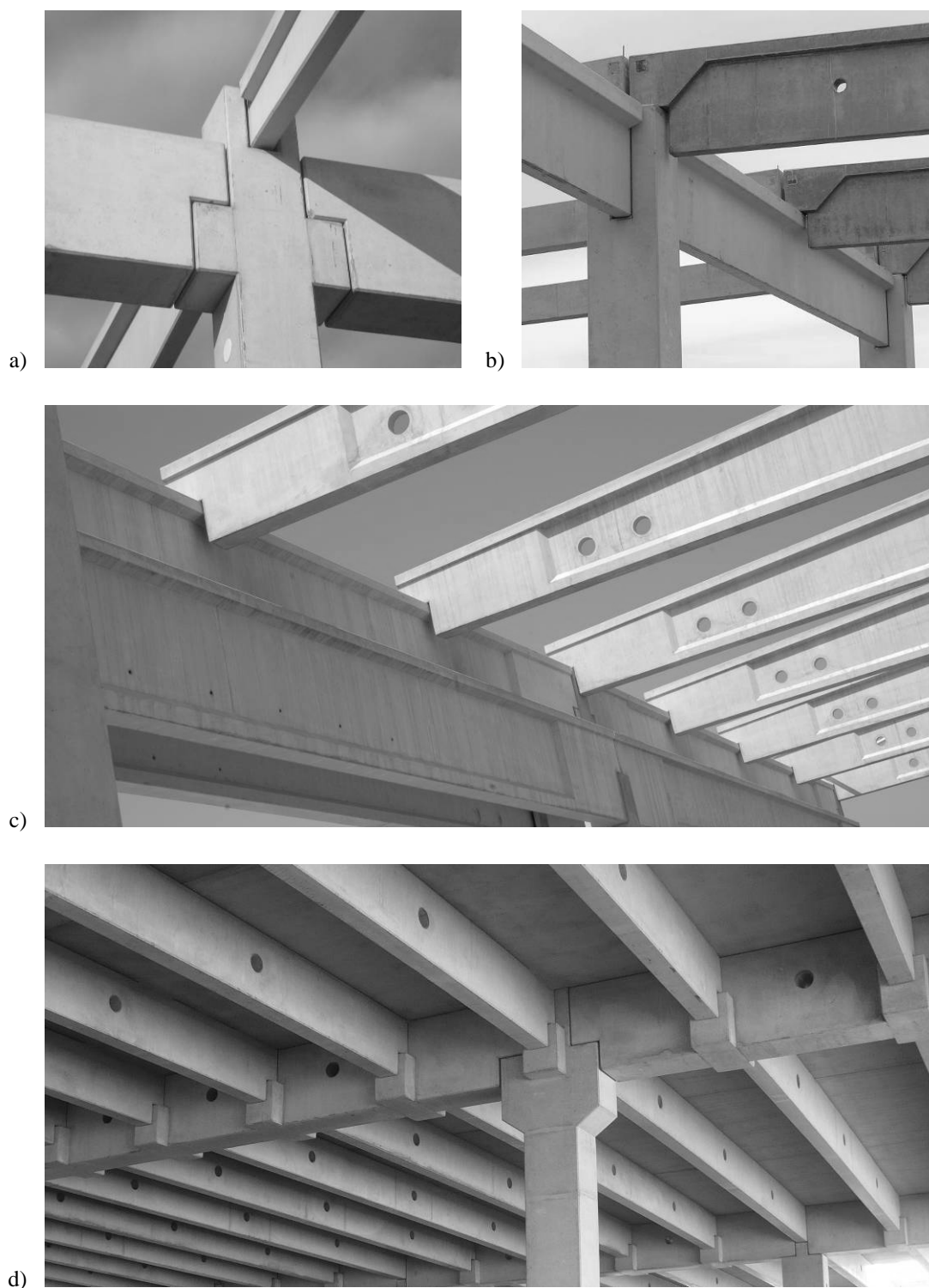
Obr. 2.9 Příklady uložení prvku ozubem z autorovy praxe: a) uložení střešních výměn obdélníkového průřezu na konzoly sloupu, b) uložení střešních vaznic průřezu T na zhlaví sloupu, resp. na přírubu střešního vazníku, pomocí rozšířeného zhlaví s náběhem, c) uložení střešních vazníků průřezu I na střešní výměnu, resp. zhlaví sloupu, s rozšířením celého průřezu před uložení, d) uložení stropních žebér na konzoly průvlaků, resp. sloupů, a jejich uložení na konzoly sloupů, realizace IP systém, a.s.
