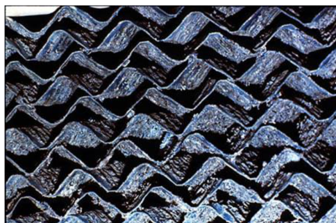
Obrázek 2.18 Usazeniny ve výplni věže [31]
