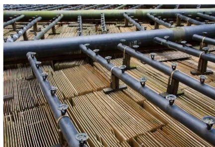
Obrázek 2.8 Sprchový systém a výplň chladicí věže, elektrárna Iru, Estonsko [21]
