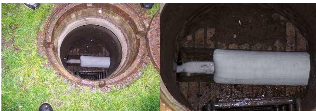
Obr. č. 43 - Rukávec procházející mezilehlou revizní šachtou.
