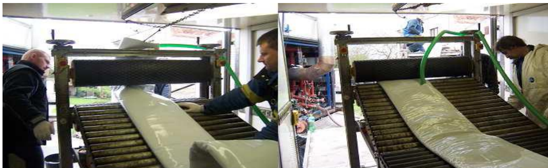
Obr. č. 40 - Plnění válce směsí pryskyřice a tvrdidla (na začátku a v průběhu práci)
