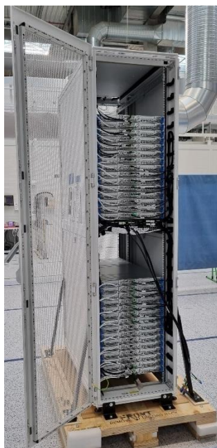
Obrázek 6. Kompletně sestavený rack (vlastní)
