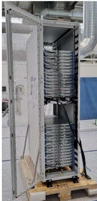
Obrázek 6. Kompletně sestavený rack (vlastní)
