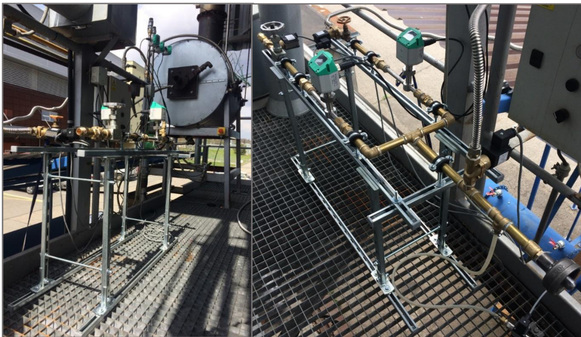
Obr. 43: Technologie směšovacího uzlu po elektrickém zapojení prvků a při zkouškách funkčnosti systému
