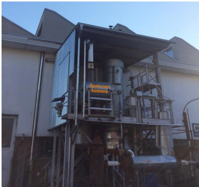
Obr. 29: Spalovací komora jako součást experimentálního zplyňovacího zařízení
