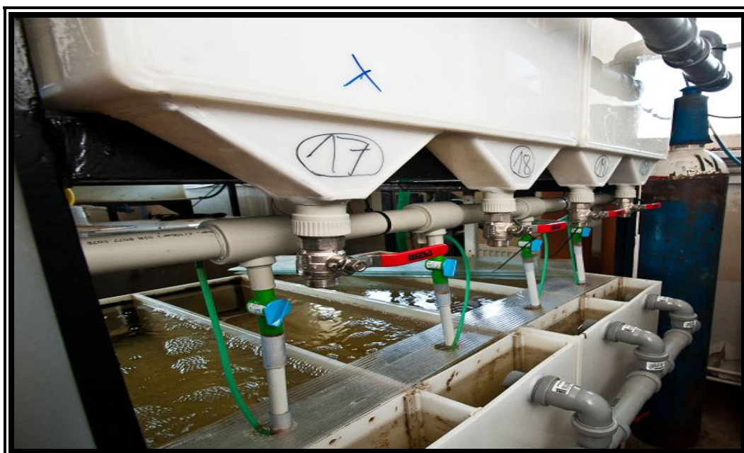
Obr. č.9. Zadní sedimentační část odchovné nádrže + odkalovací ventil
