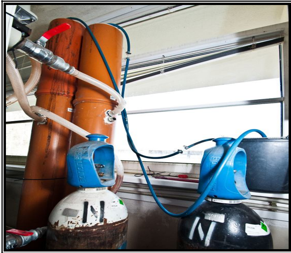
Obr. č.8. Směšovací válec, tlakové láhve s kapalným O 2 a N 2
