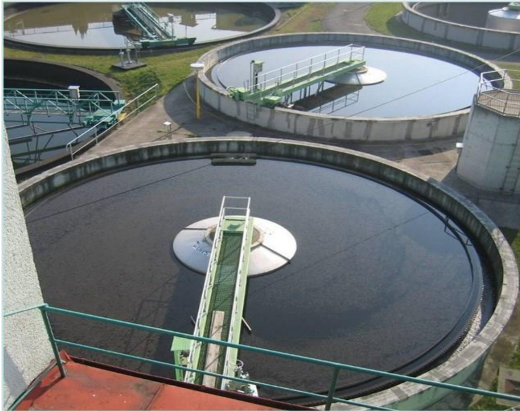
Obrázek 6 - Dosazovací nádrž (ORLEN Unipetrol RPA)
