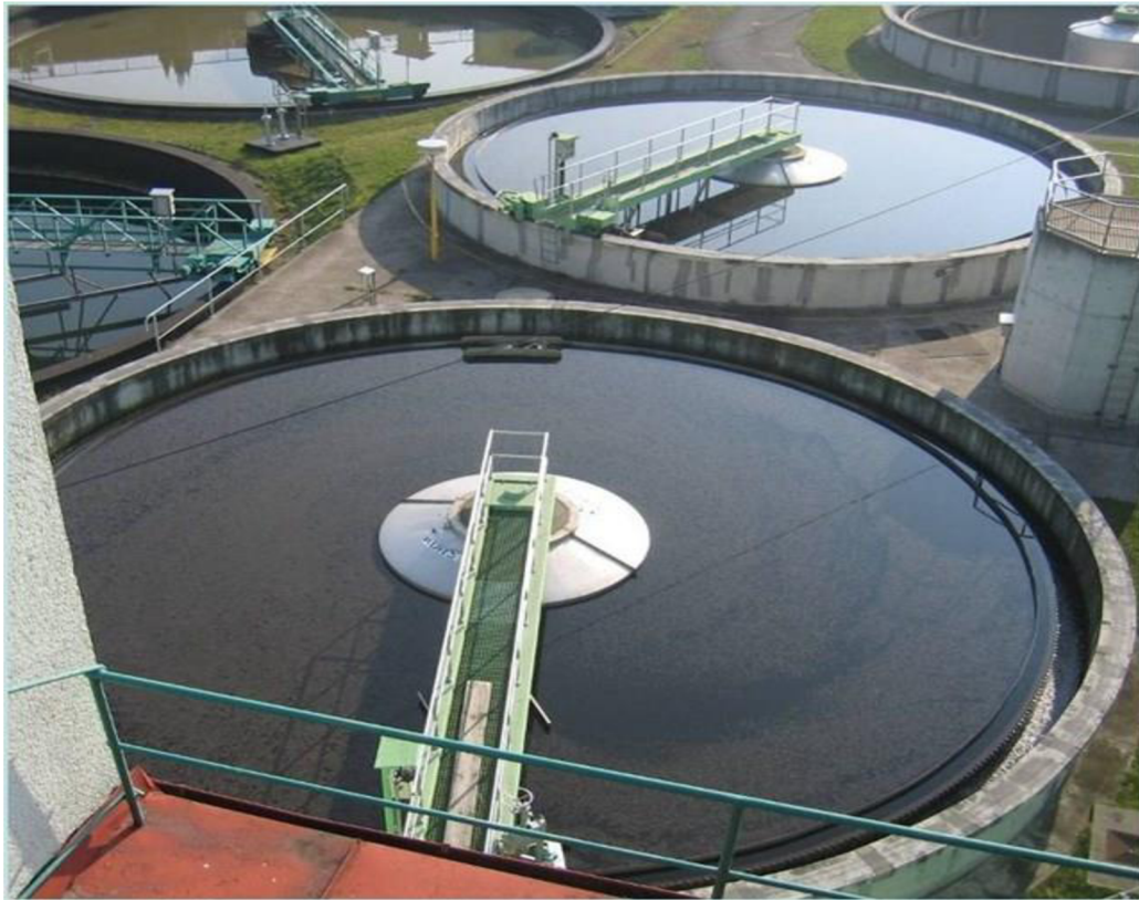
Obrázek 6 - Dosazovací nádrž (ORLEN Unipetrol RPA)
