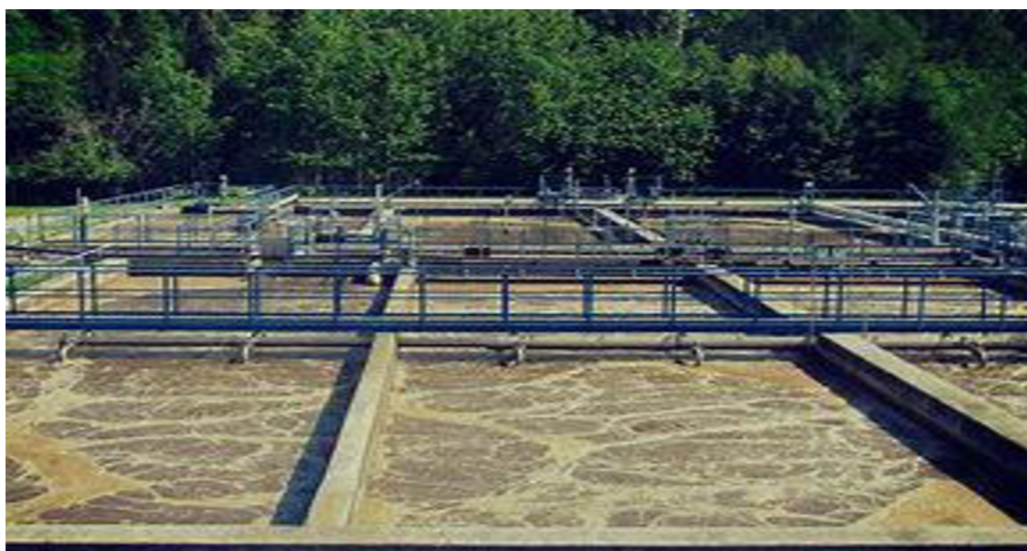
Obrázek 3 - Čistírna odpadních vod (Vodárenství.cz)
