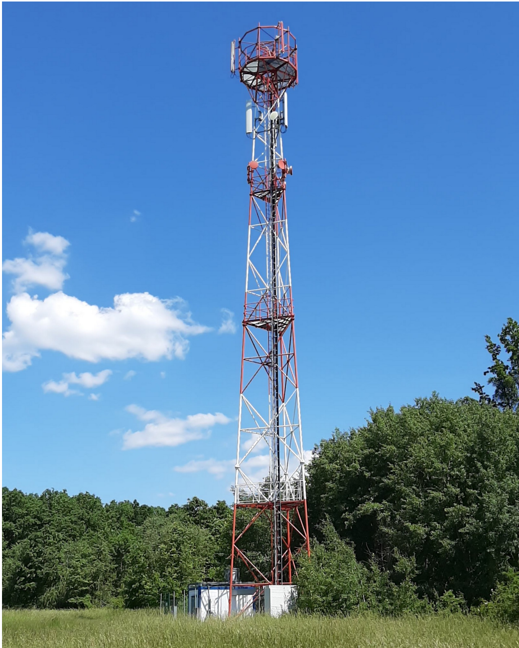
Obr. 4: Základňová stanica mobilnej siete s anténami na stožiar
