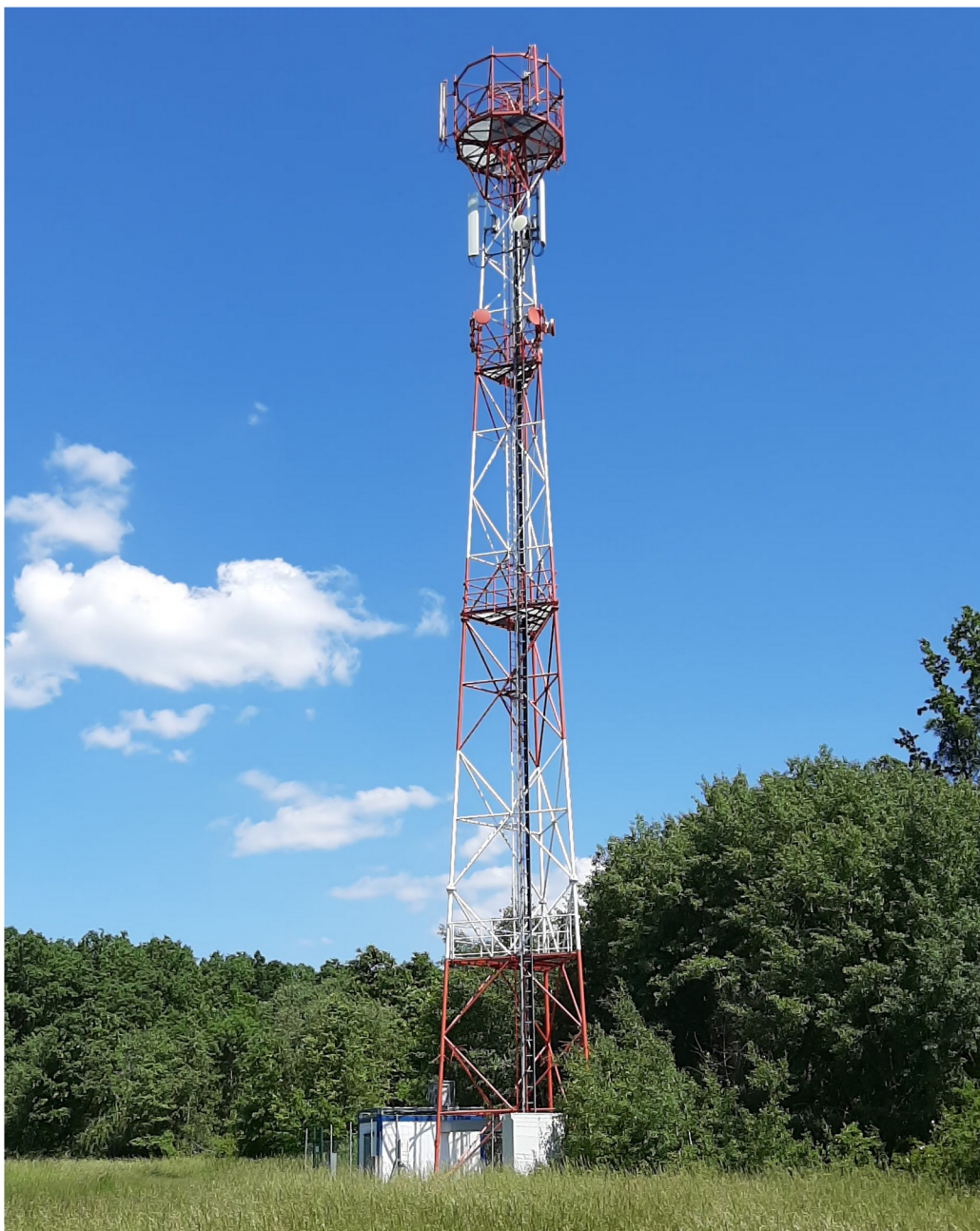
Obr. 4: Základňová stanica mobilnej siete s anténami na stožiaroch
