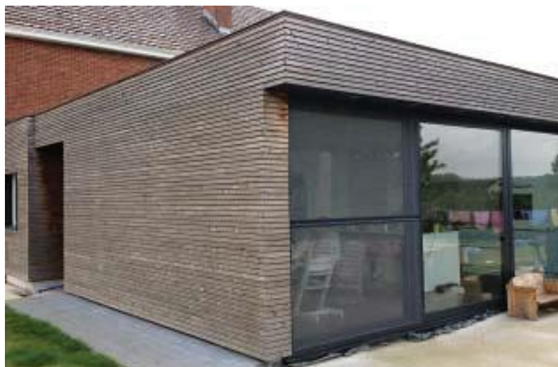
Obr. 21 Barevná změna fasádního obkladu (www.prokom.cz)
