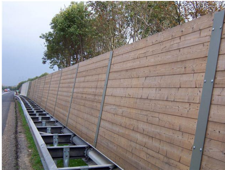
Obr. 53 Ukázka využití PlatoWood dřeva v praxi – protihluková stěna ( www.ecochoise.co.uk )
