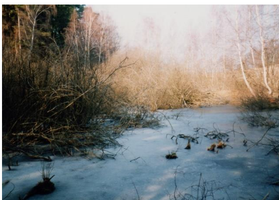
Obr. 21 Vodní nádrž, poničená hráz (foto: vlastní)
