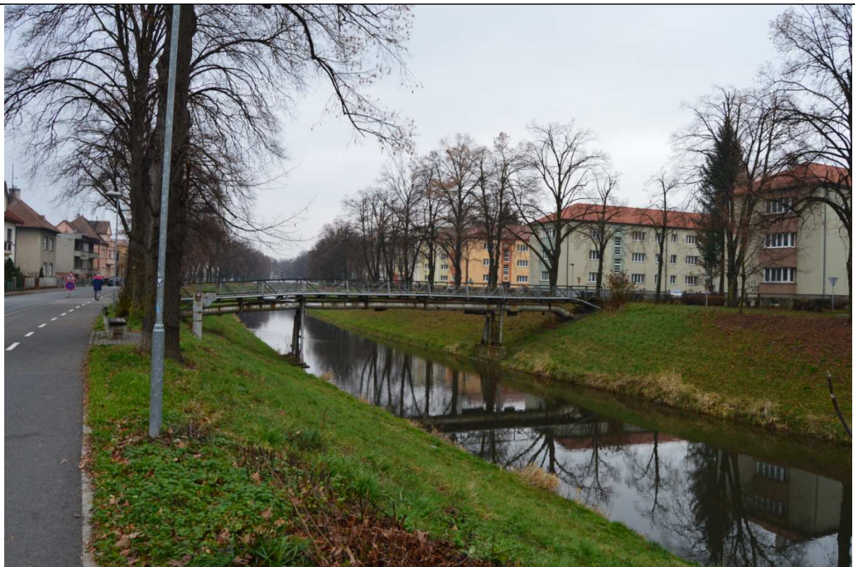
Foto 020: Silniční most Cigánecký v km 13,291
