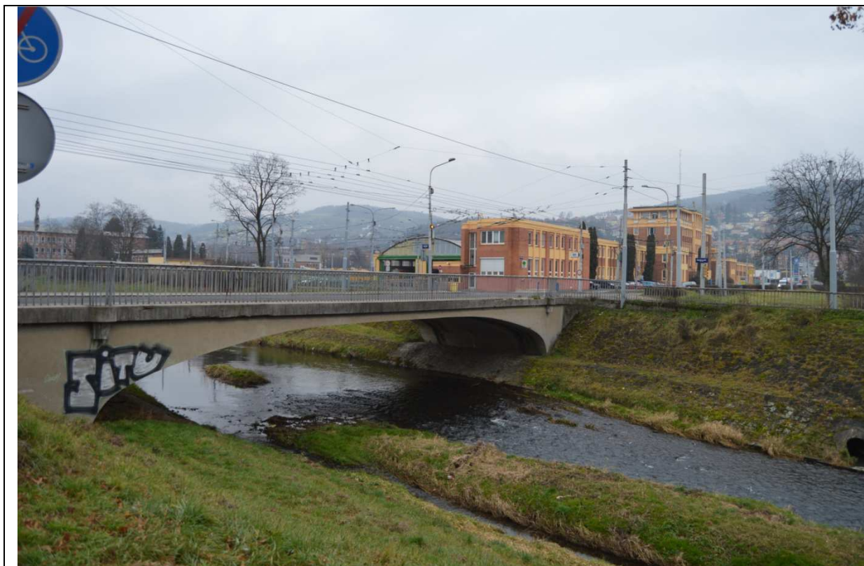
Foto 033: Silniční most u nemocnice v km 14,909, zanesené koryto
