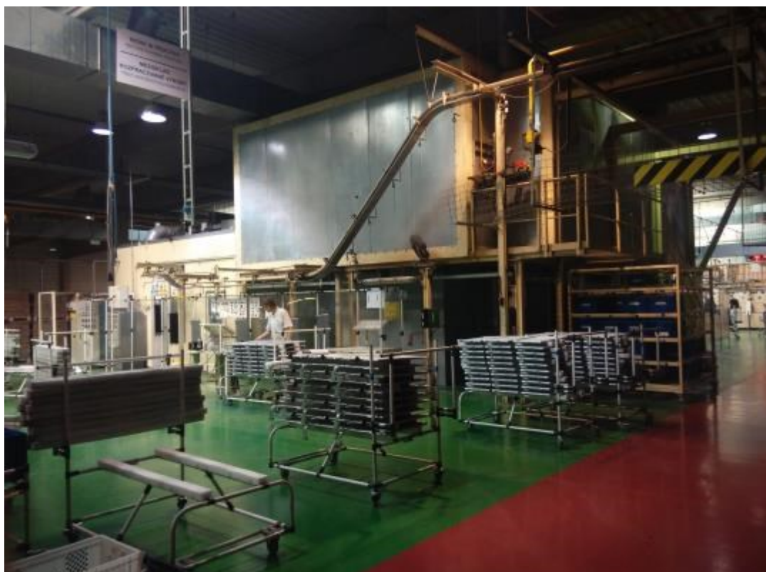
Obr. č. 16 Nástříková komora s vypalovací pecí
