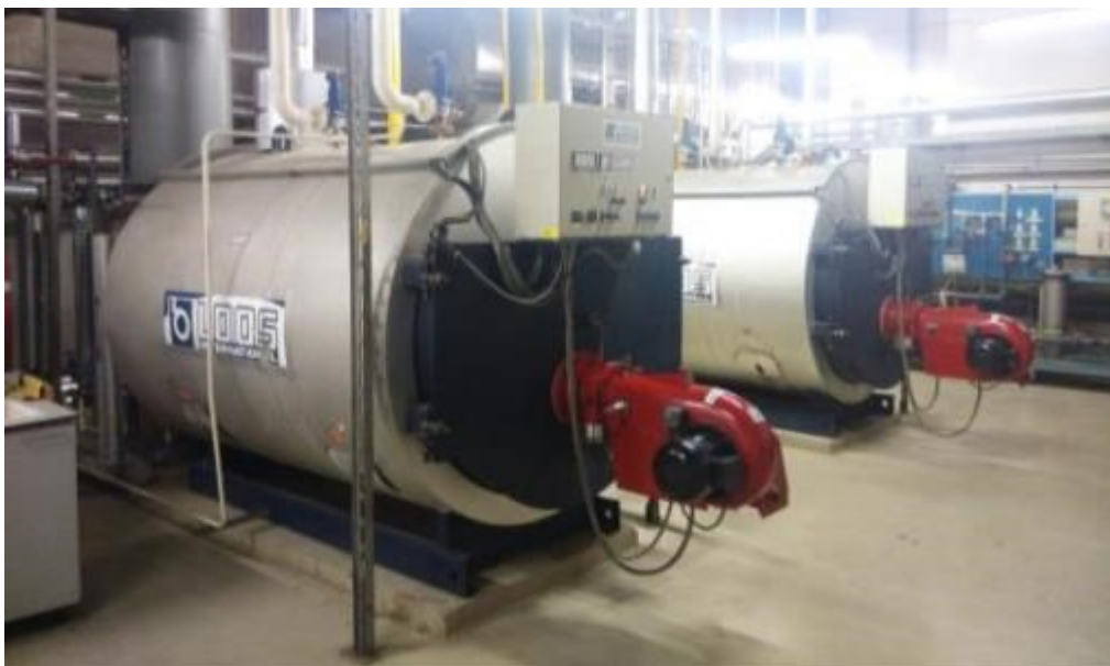
Obr. č. 18 Plynové kotle K1 a K2
