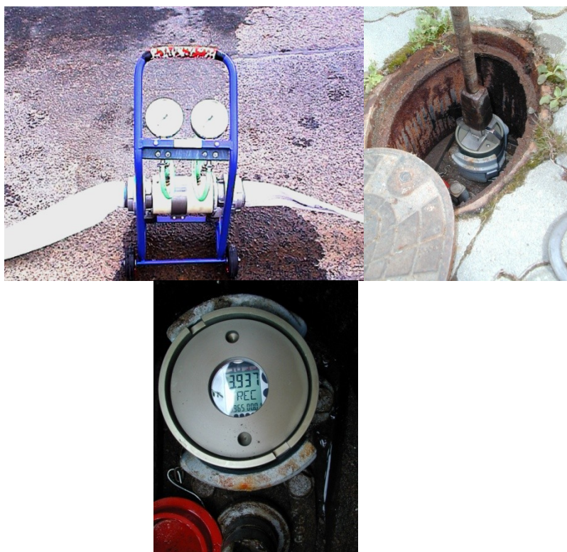
Obr. 4 – Měřicí souprava hydrantových testů
