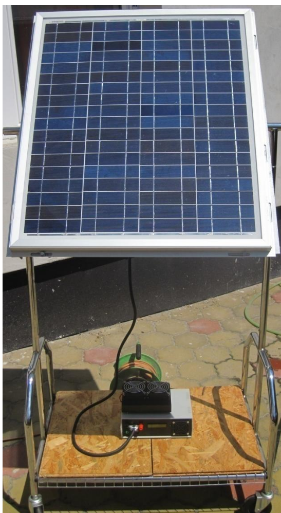
Obrázek 31: Experimentální instalace FV panelu 65 Wp
