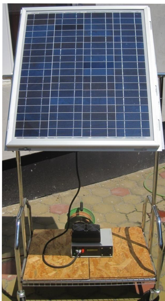
Obrázek 31: Experimentální instalace FV panelu 65 Wp
